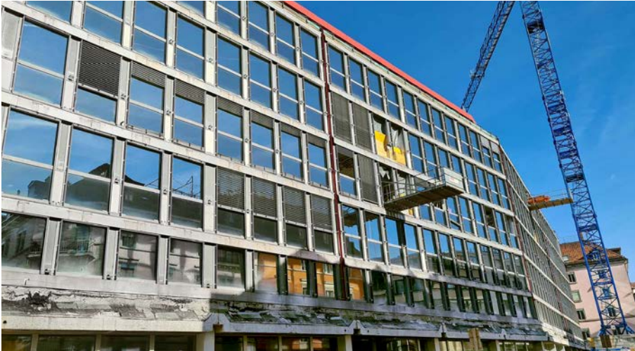
Die Immobilie an der Müllerstrasse in Zürich wird im Sinne der Kreislaufwirtschaft entwickelt.
