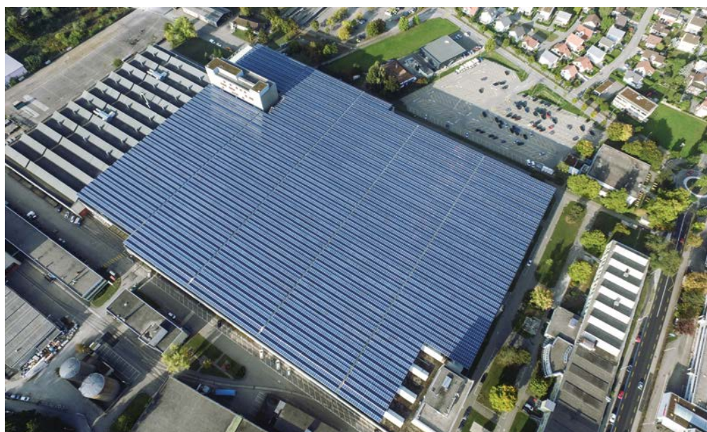
Zuchwil, Photovoltaikanlage Riverside, Baujahr 2015 Auszeichnung: Solarpreis 2016
